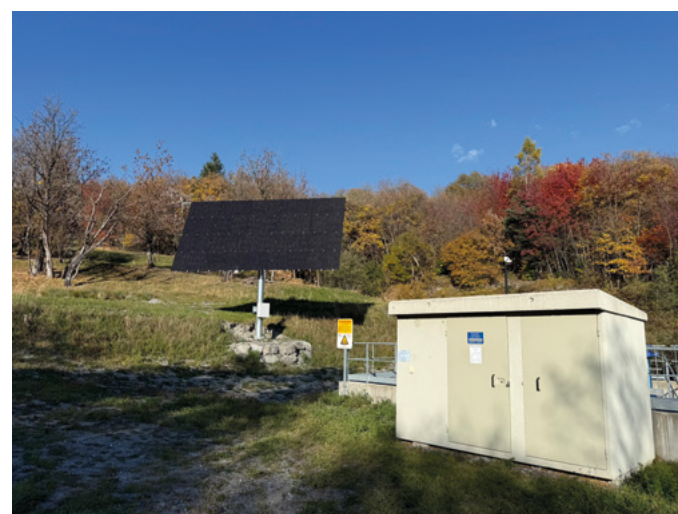
Tracker solaire sous la Planchette
